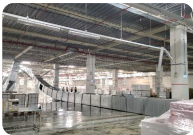
空調系統損害
