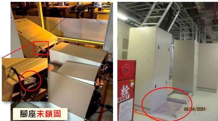
附屬機台倒塌、移位
