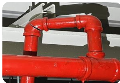
消防系統損害
