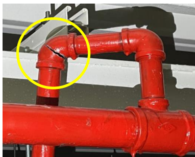
管路擺幅造成的應力破壞
