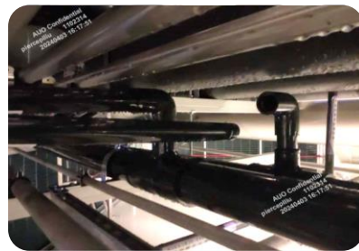
供水系統損害
