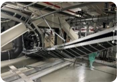
電力系統損害
