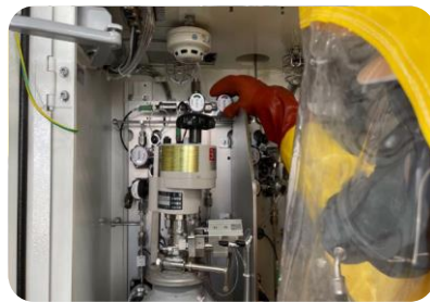
氣化系統損害
